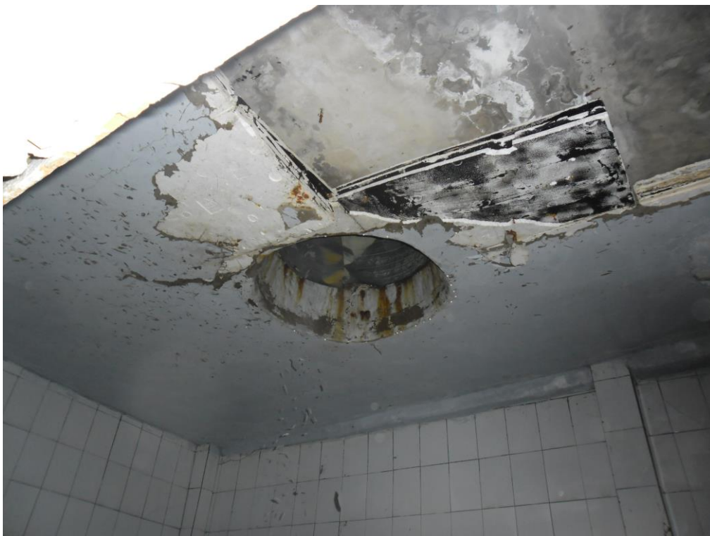
Figure 16 – Exemple de mauvaise pratique : ouverture dans le plafond pour une machine à glace : environnement sale et entraînant des risques de contamination
